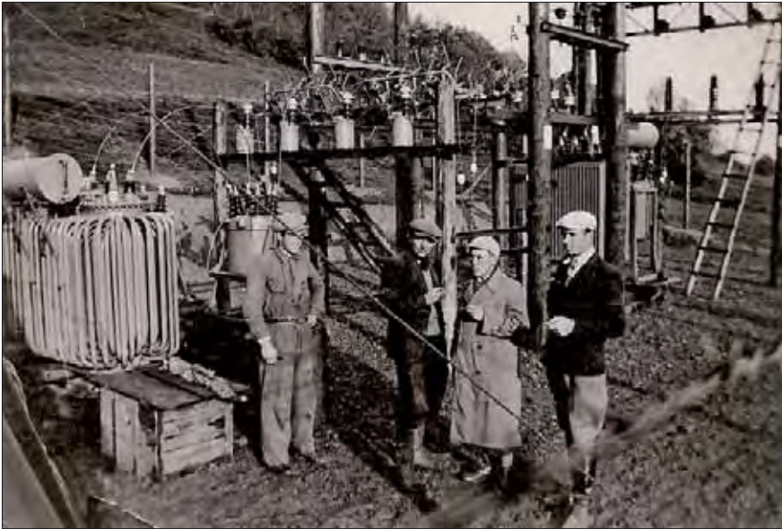
Prowizoryczna stacja do zasilania budowy elektrowni w Czchowie – rok 1938
